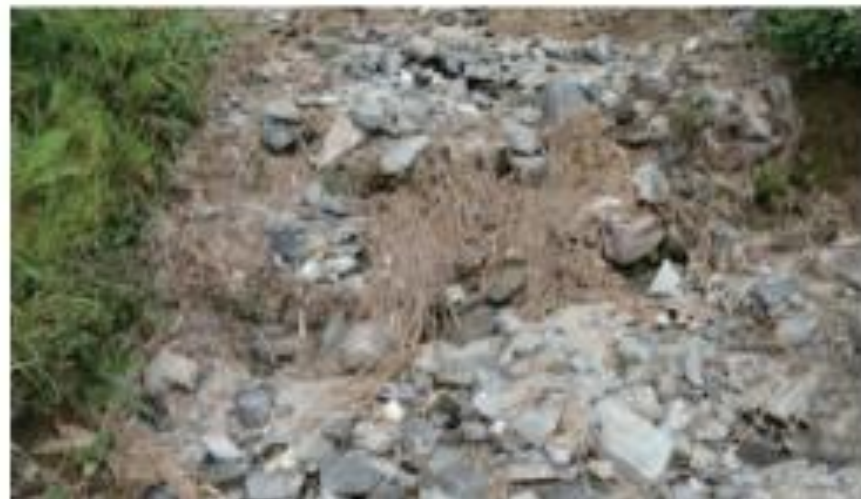
2022年8月の豪雨で洗堀した下部
